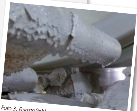
Foto 3: Feinstoffablagerungen im Randbereich.
