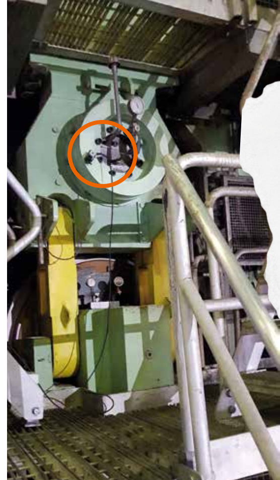
Foto 3: Position des Beschleunigungsaufnehmers an der Oberwalze der 2. Presse
