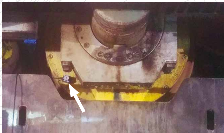
Abb. 7: Position Schwingungssensor am Lagergehäuse der Oberwalze 2. Presse
