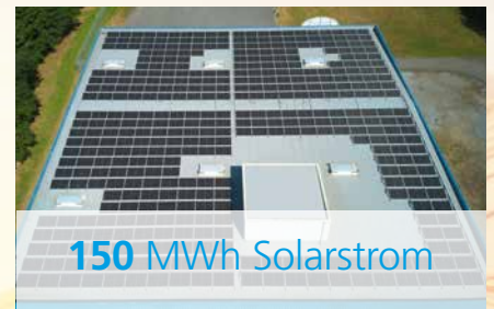
PV-Anlage Heimbach Specialities, Belgien
