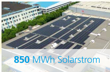
PV-Anlage Heimbach Suzhou, China
