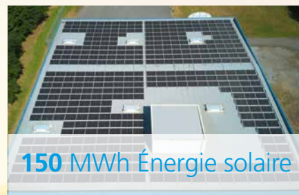
Le photovoltaïque, Heimbach Specialties, Belgique
